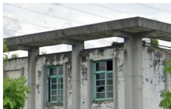
圖 42. 挑簷與牆面間留縫的案 例：臺電岡山變電所 8
