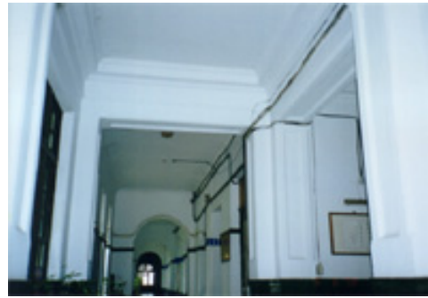
(b) 室內配線凌亂例〔不良〕
